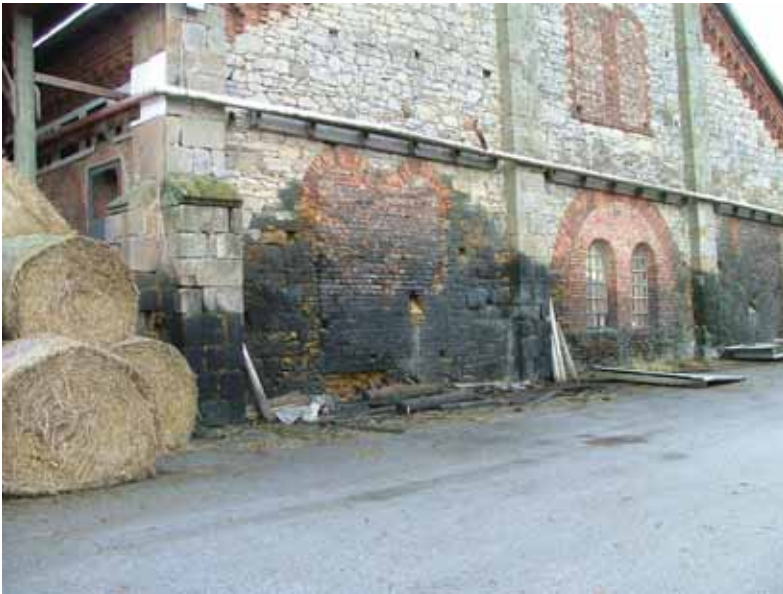
Durch Lagerung von frisch imprägnierten Hölzern verunreinigte Nordwand der Imprägnier-/Sägehalle
